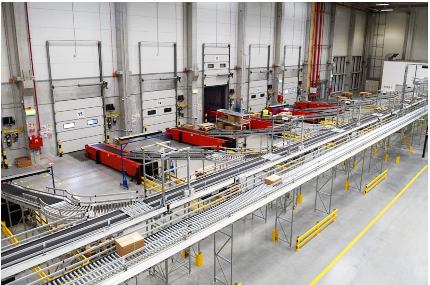
Es sind 24 Verladeteleskope zur komfortablen Beladung im Einsatz.
